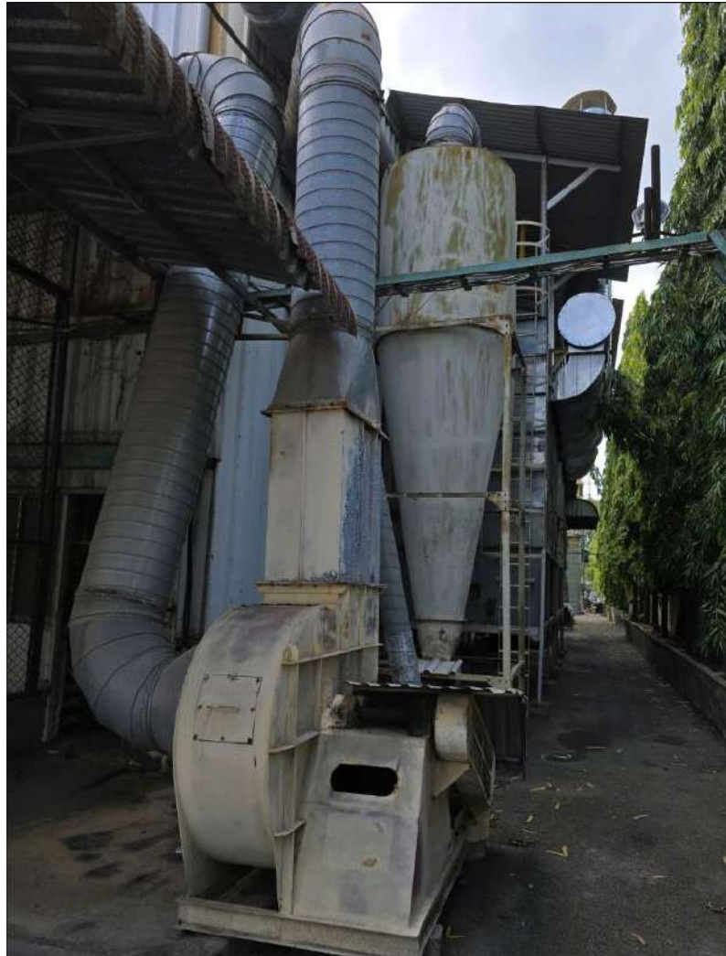
Hình 3. 15. Hình ảnh Hệ thống xử lý bụi gỗ tại xưởng 3
