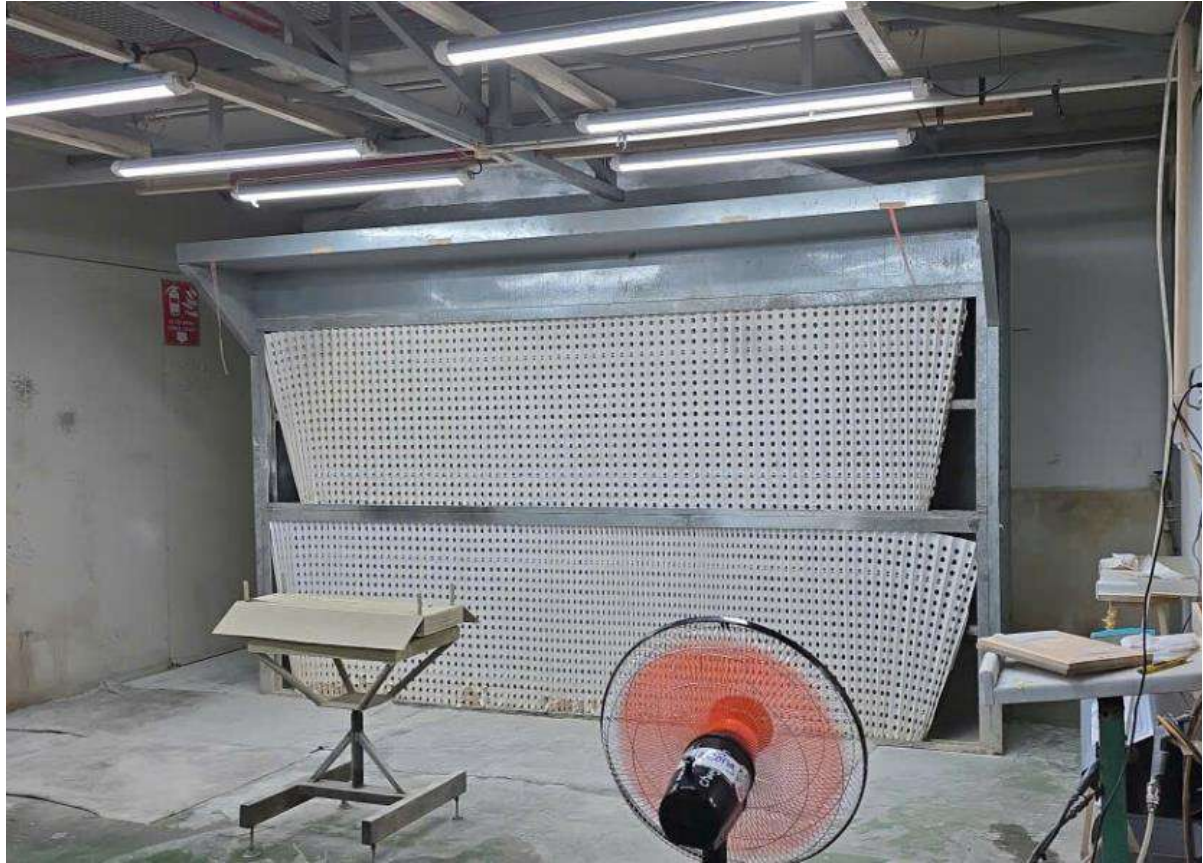
Hình 3. 17. Hệ thống xử lý khí thải từ quá trình sơn tại xưởng 3
