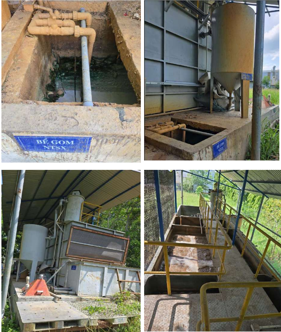
Hình 3. 6. Hình ảnh Hệ thống xử lý nước thải của cơ sở
