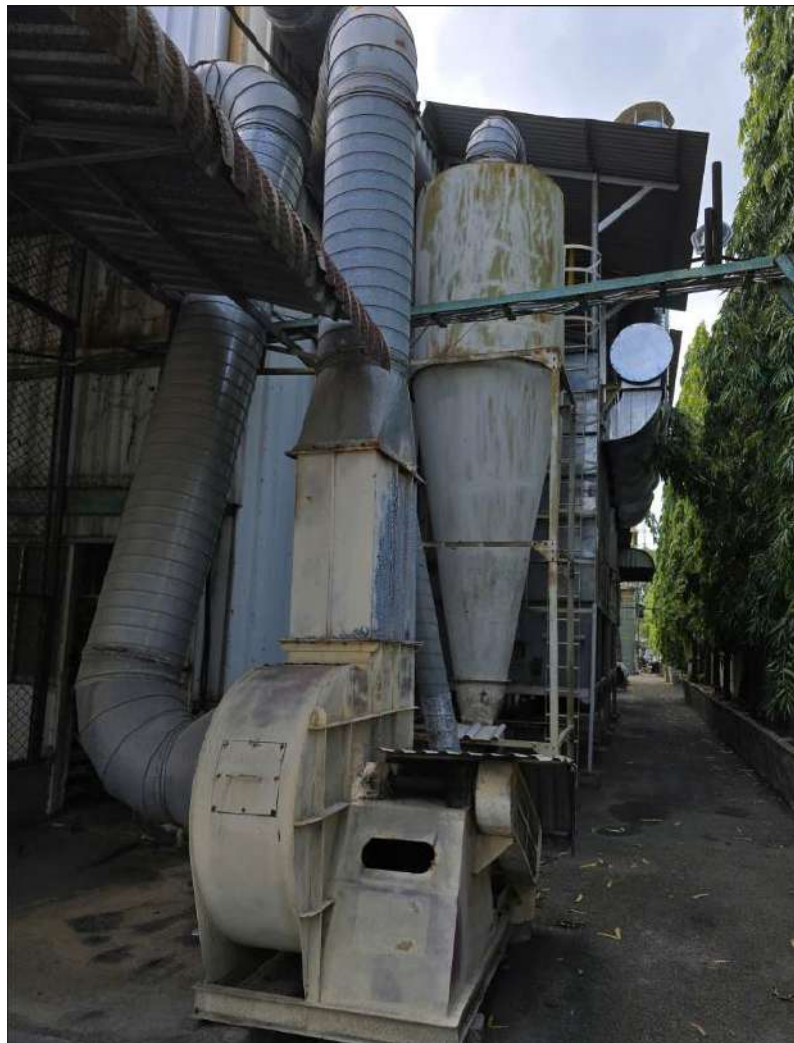
Hình 3. 13. Hình ảnh Hệ thống xử lý bụi gỗ bằng Cyclone kết hợp thùng lọc bụi túi vải tại xưởng 2 và xưởng 3
